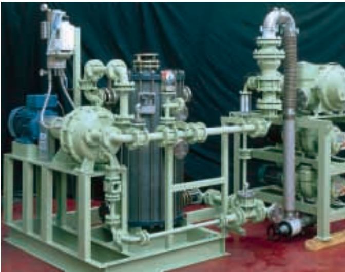
Vakuumpumpanlage für abs. Drücke bis 2 mbar (A) bestehend aus einer dreistufigen Wälzkolbenpumpenkombination und einer nachgeschalteten Flüssigkeitsring-Vakuumpumpe Typ FGP. Die Anlage wird in einem kontinuierlichen Verdampfungsprozess eingesetzt wo HCl-haltige Dämpfe abgesaugt werden.
